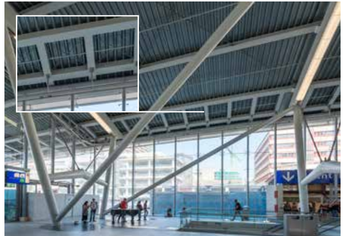
5. Rails voor de glazenwasinstallatie binnen.
