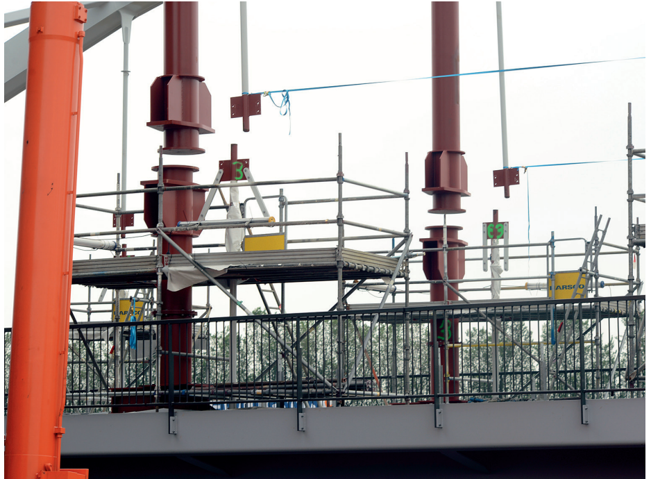
Volgende stap: aanbrengen van de hangers met hulp van drie tijdelijke, verstelbare kolommen per boog.
