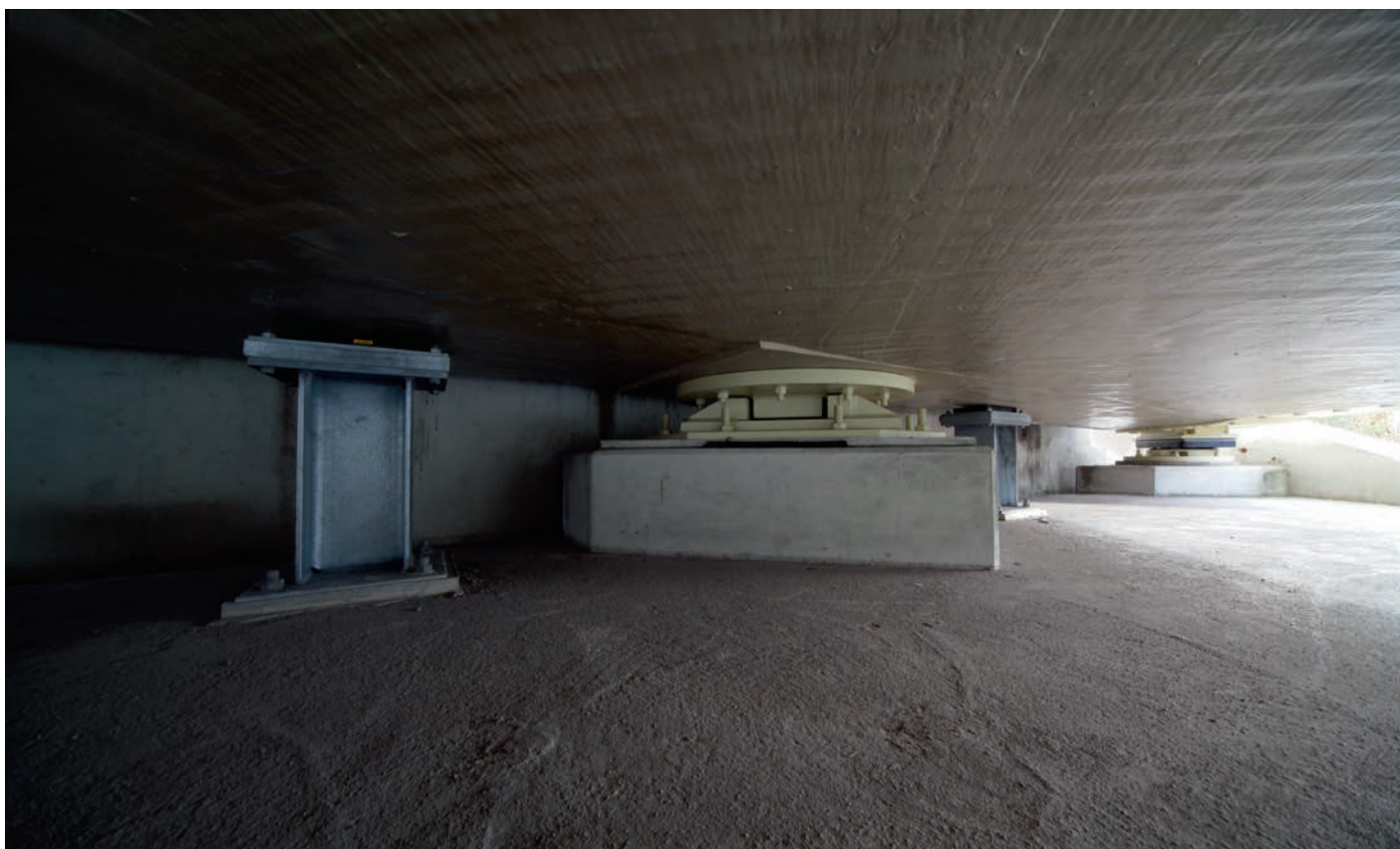
Het viaduct ligt op alzijdig beweegbare potopleggingen. Bij de landhoofden houden doken het viaduct in dwarsrichting vast, vanwege de aanrijdbelasting.
