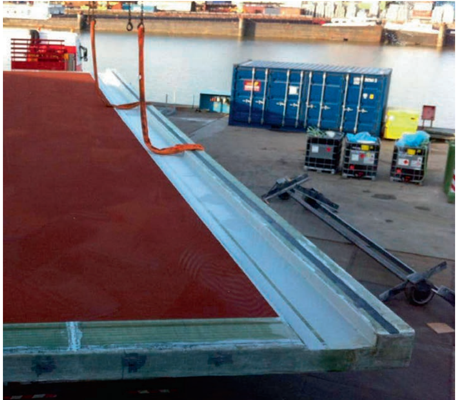
De ruimte tussen het U-profiel en de vloer wordt geïnjecteerd voor een volledige verbinding.
